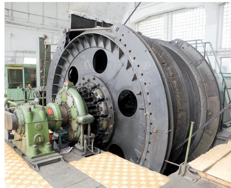
O generaci mladší elektrický těžní stroj Č. K. D. o maximálním výkonu 715 kW spojený s těžním strojem ve strojovně jámy II. dolu Centrum. Foto: Jiří Chmelenský, srpen 2016.
