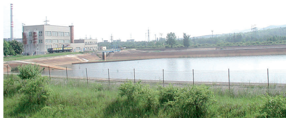
Úpravna důlních vod je jednou z nejdůležitějších částí technologie úseku odvodnění. Foto: archiv DN
