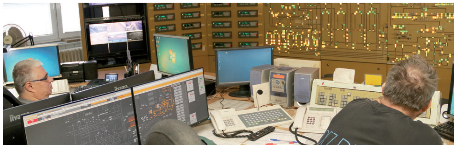
Součástí obměny řídicího systému na úpravně uhlí je také stěhování dispečinku. Foto: (pim)
