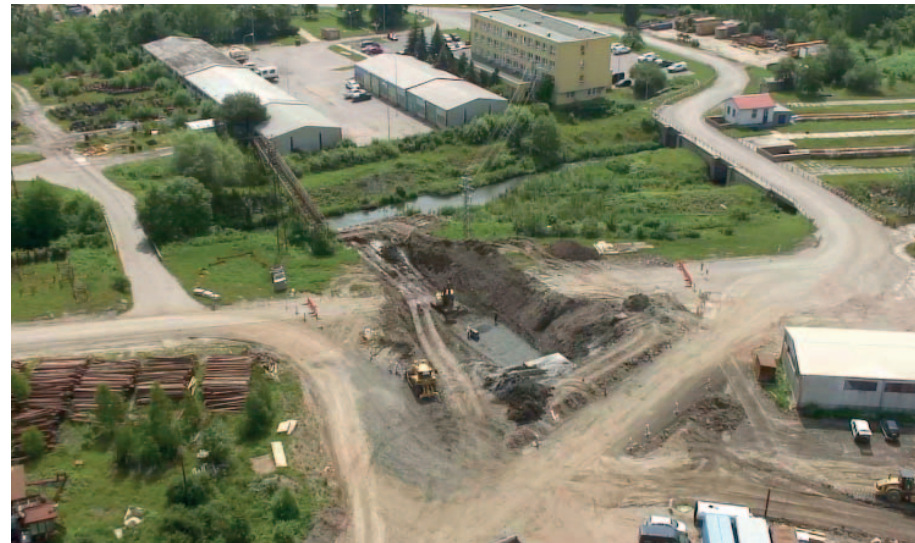
Práce na propojení Vesnického potoka s řekou Bílinou z ptáčích perspektivy. Foto: Dron Czech Coal Power
