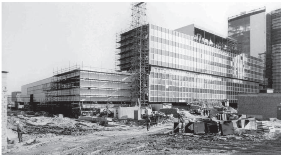
Takto vypadala provozní budova v sedmdesátých letech minulého století, když se teprve stavěla. Foto: Archiv Seven EC
