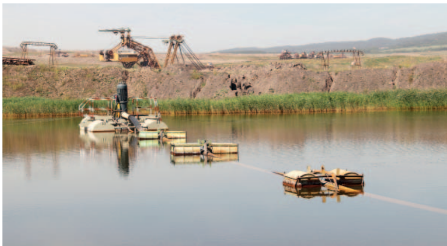
Také pomocná čerpací stanice v lomu ČSA musela být osazena náhradním čerpadlem. Foto: (pim)
