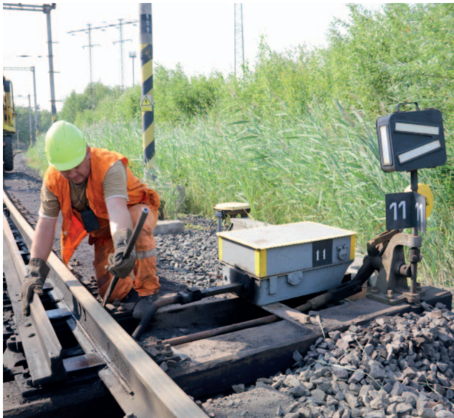
Špičkaři se starají o více než čtyři stovky výhybek, které spravuje úsek traťového hospodářství. Foto: (pim)
