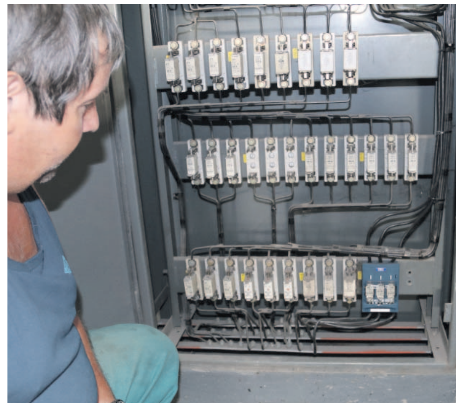
Zařízení, se kterými provozní elektrikáři pracují, se neustále mění. Foto: (pim)
