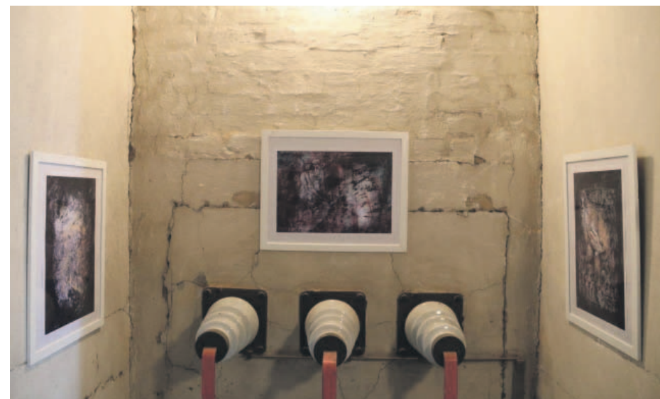
Bývalá rozvodna Dolu Julius III je dnes netradičním výstavním prostorem s unikátní atmosférou. Foto: Archiv DN
