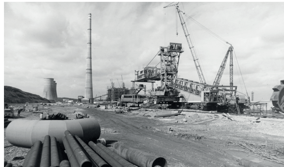
Více než dvě stě metrů komína se podařilo postavit za necelého půl roku.
